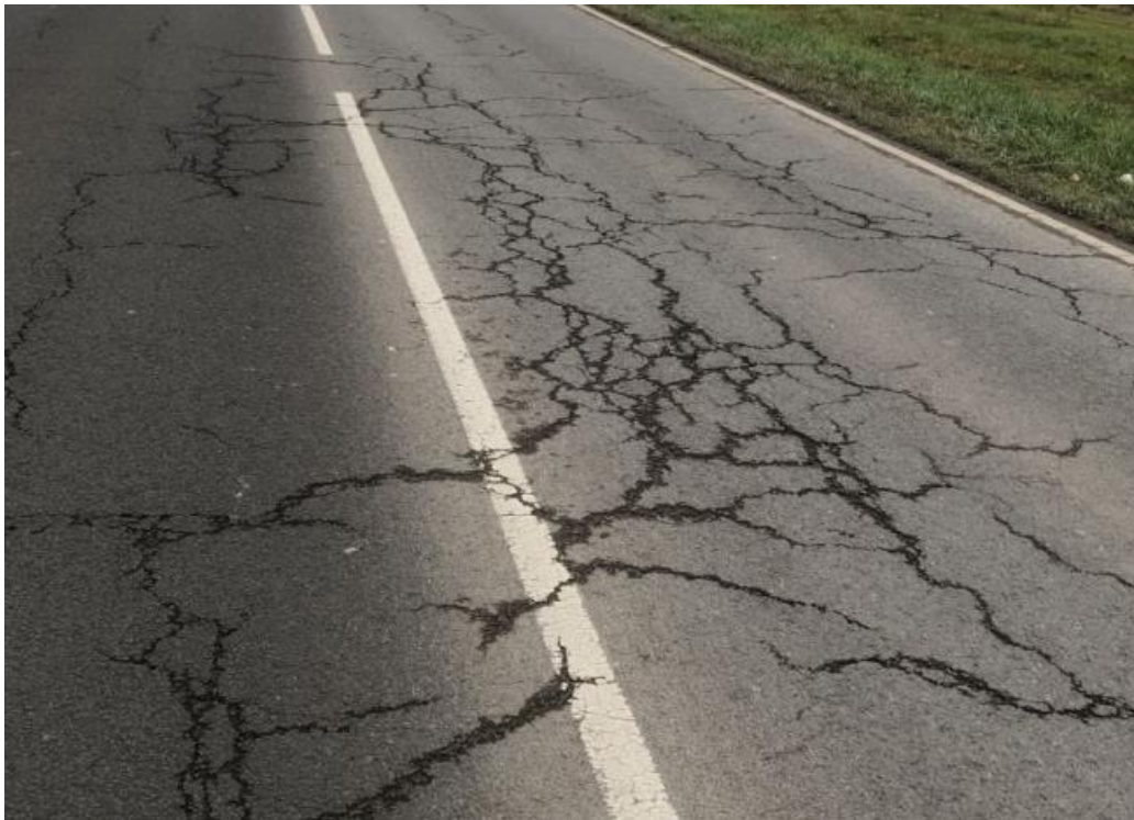
Die Schäden auf der L 546 sind unübersehbar.
